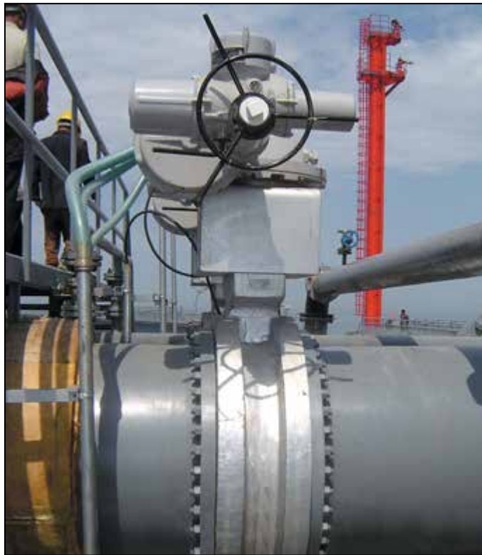
Un robinet à papillon à triple excentration Torqseal™ utilisé pour le transport du pétrole brut au port de Dalian, en Chine.
